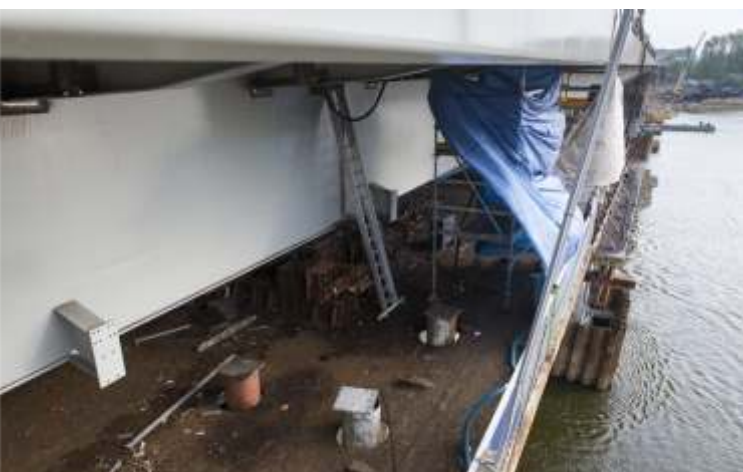
Na konstrukcji mostu poniżej chodnika znalazły się specjalne zaczepy. To do nich zostanie przymocowana kładka dla rowerzystów
