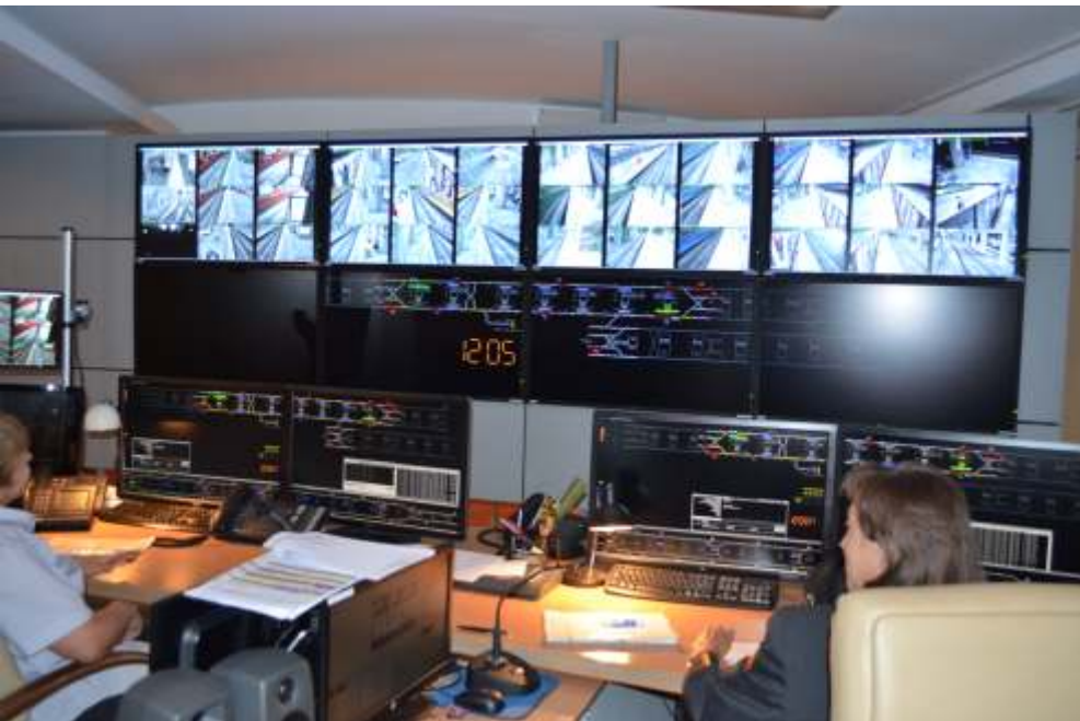
Stanowisko dyspozytorów drugiej linii metra
