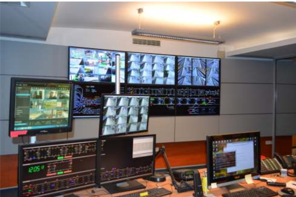
Stanowisko dyżurnego metra – na ścianie monitory z podglądem stacji i tuneli pierwszej i drugiej linii metra oraz schematy obrazujące aktualny ruch pociągów. Po prawej stronie dyżurnego znajduje się stanowisko dyspozytora drugiej, a po lewej – pierwszej linii metra
