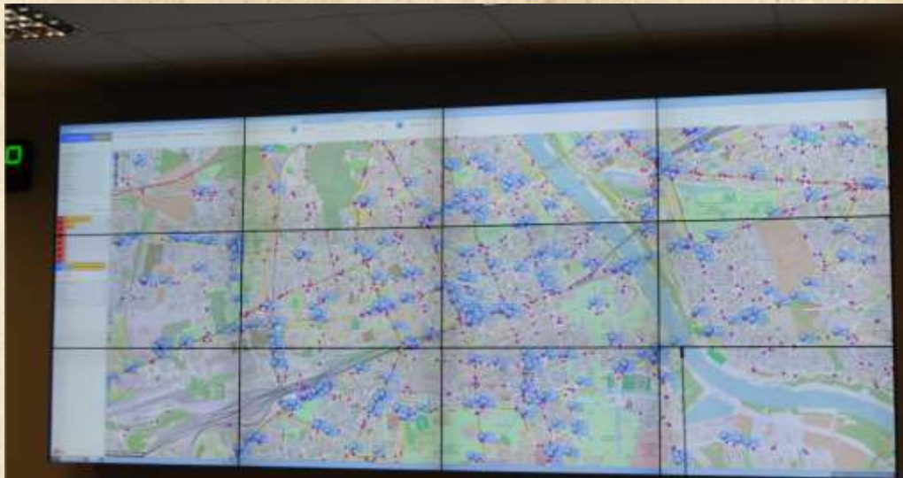
Głównym elementem wyposażenia centrali ruchu MZA jest ekran, na którym widać bieżące położenie wszystkich pojazdów operatora
